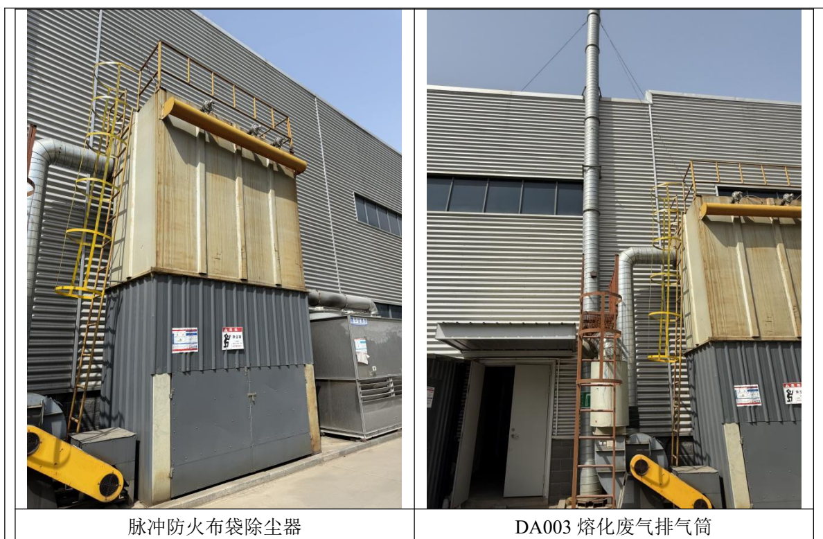
图 3-1 废气治理设施图
