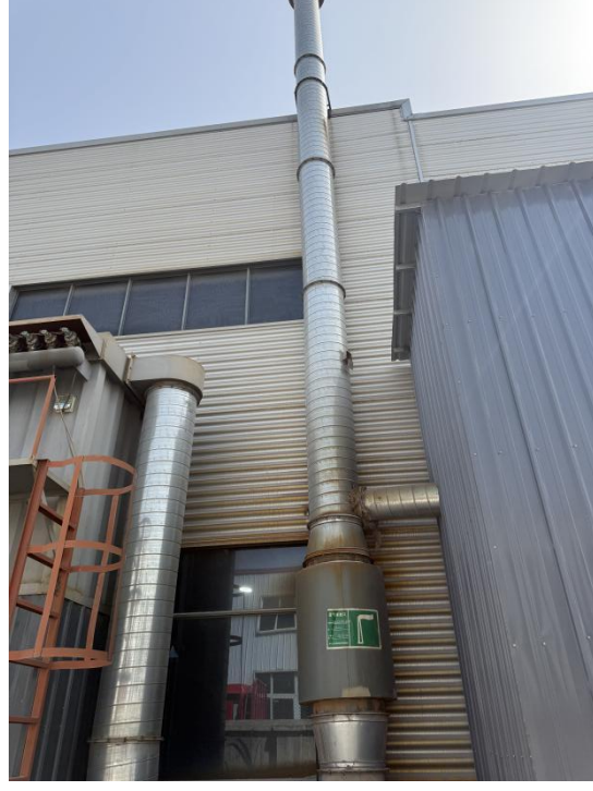
DA002 抛丸、打磨粉尘、落砂、砂回收废气 排气筒
