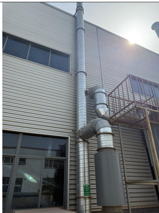
DA001 制芯、浇注废气排气筒
