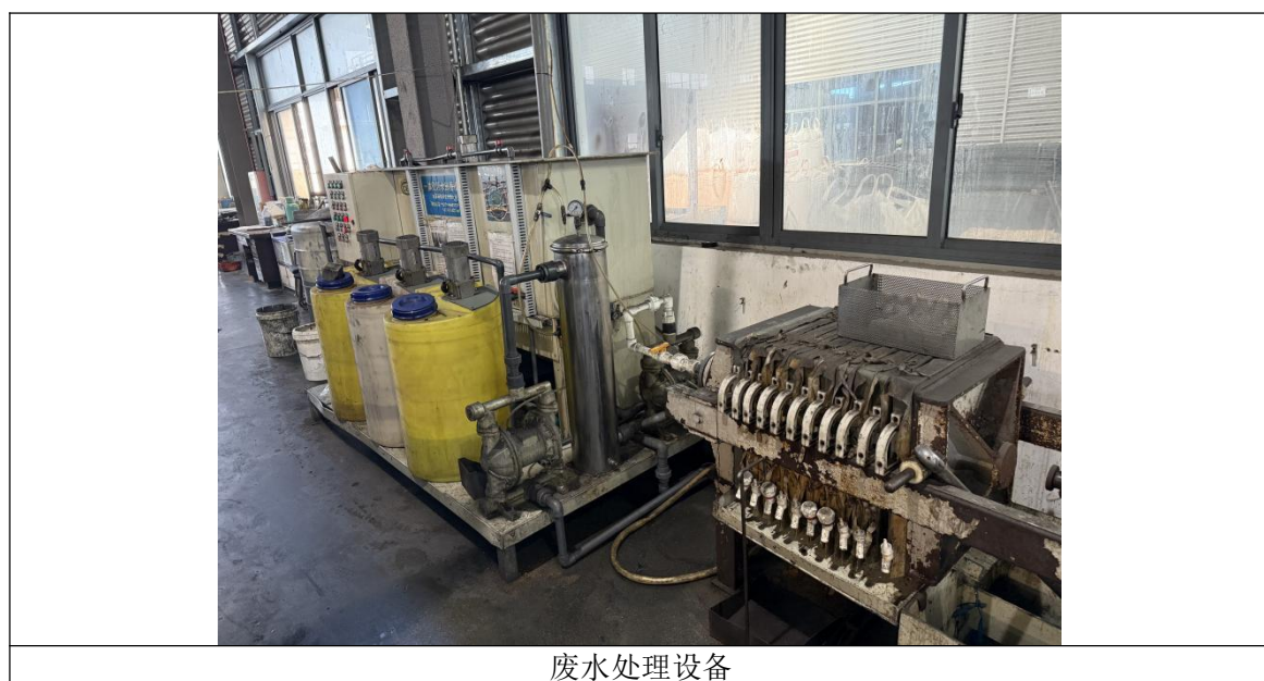
图 3-2 废水治理设施图
