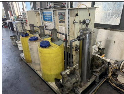
废水处理设备
