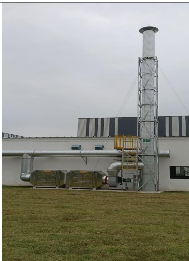
危废间废气排气筒(DA017)及环保设备
