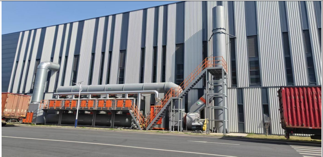
调漆、喷漆、晾干排气筒(DA003)及环保设备
