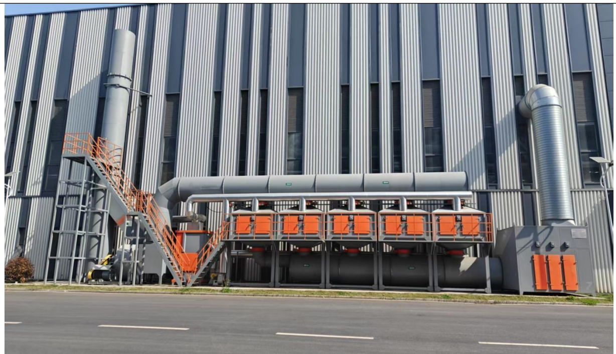
调漆、喷漆、晾干排气筒(DA001)及环保设备
