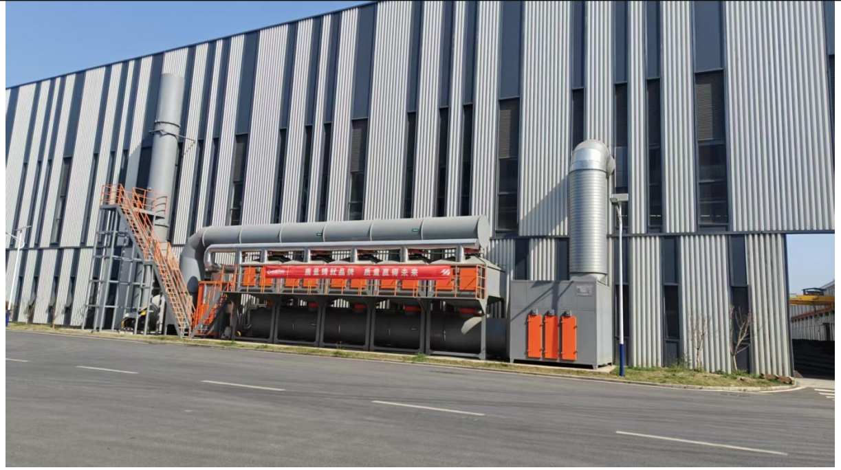
调漆、喷漆、晾干排气筒(DA002)及环保设备
