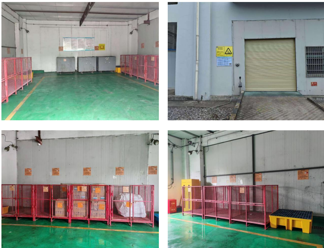
图 3-2 危废暂存间设施图
