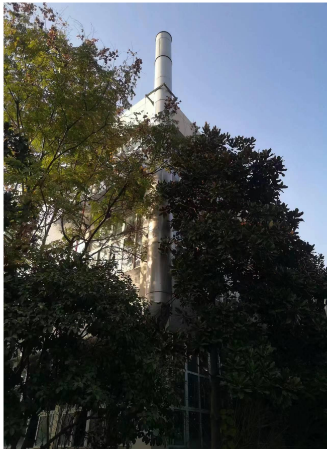
锅炉燃烧排气筒（DA002）
