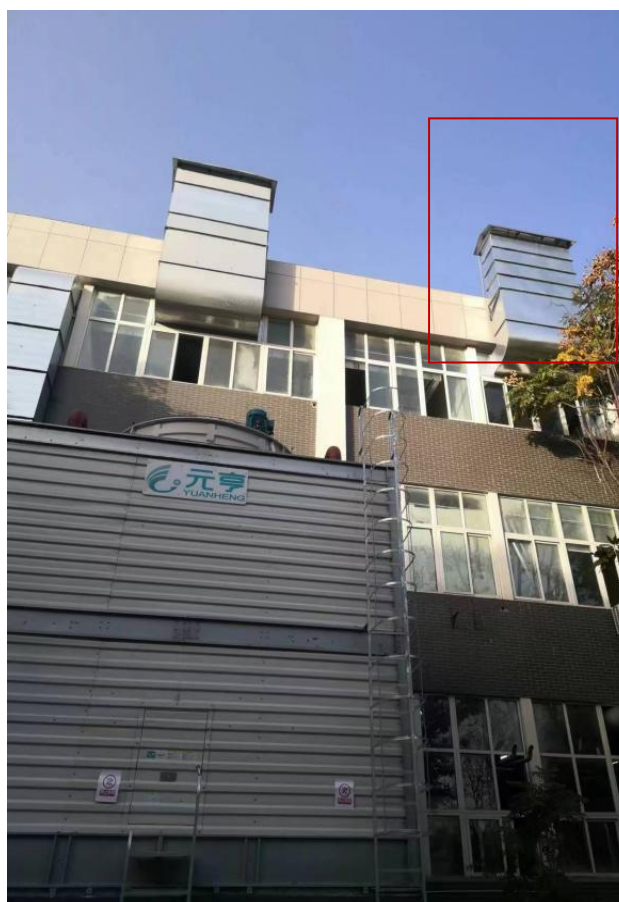
7#涂布生产线废气排气筒（DA005）
