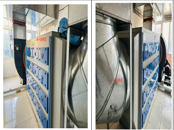
废气治理设施
