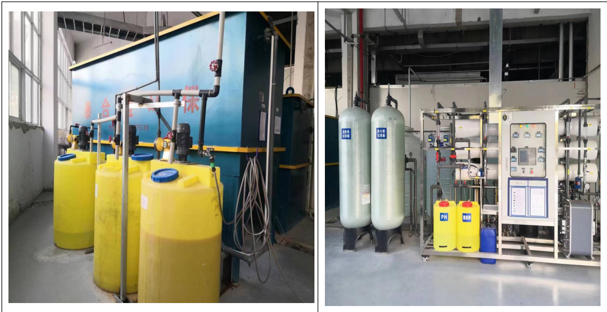
图 3-2 废水处理装置
