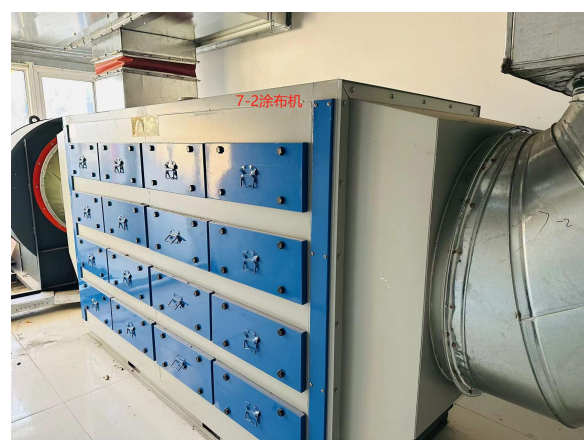
废气治理设施
