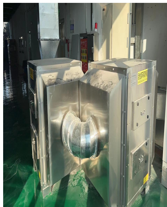
废气治理设施
