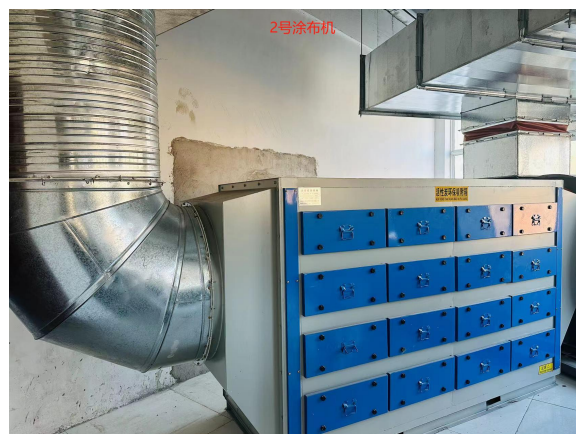
废气治理设施
