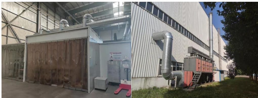
图 2-15 现有喷漆房、喷漆废气处理设施现场情况
