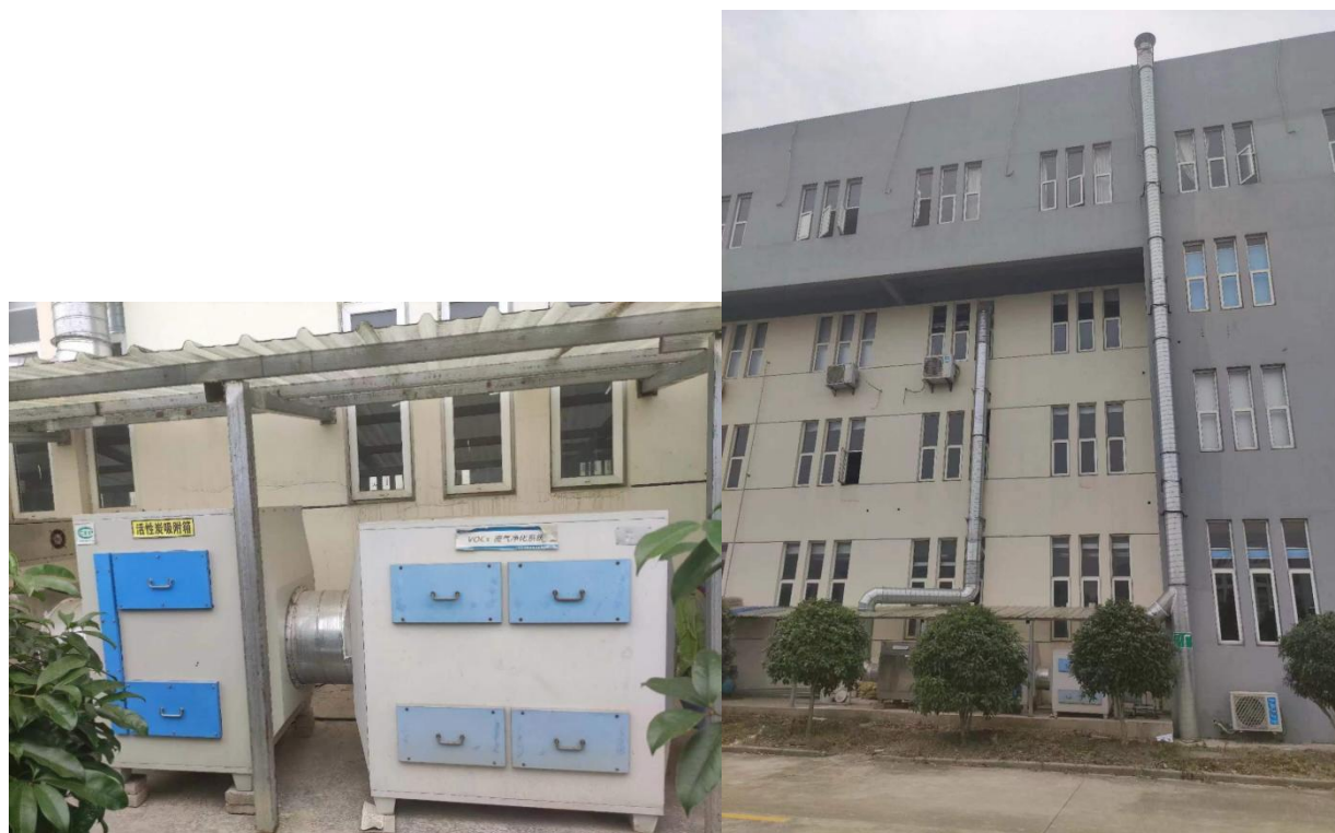
废气处理装置
